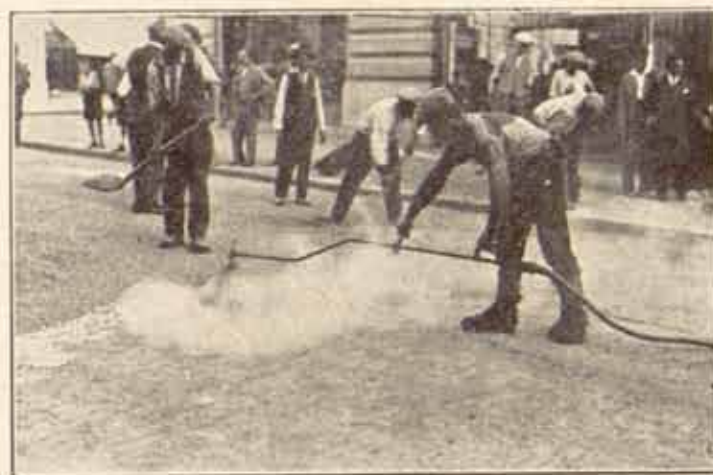
Оправка дошројале дрвене калдрме у Краља Петра улици. Фуге су најчешће изсушеном и поочиће сирамскерање.
